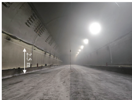
图 5 试验隧道负离子净化器安装位置
